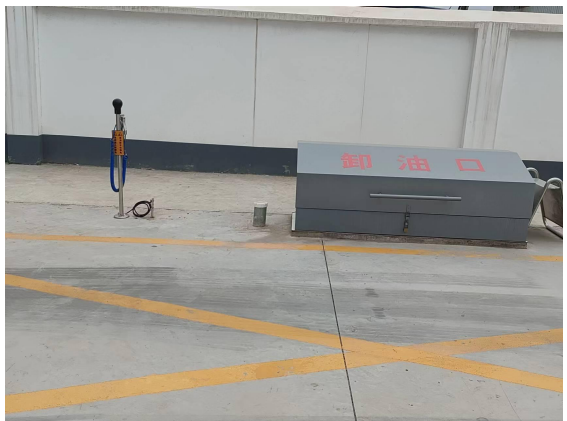
静电释放器、卸油口
