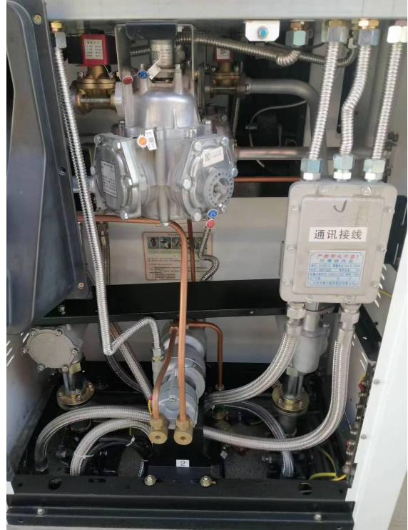
油气回收设备
